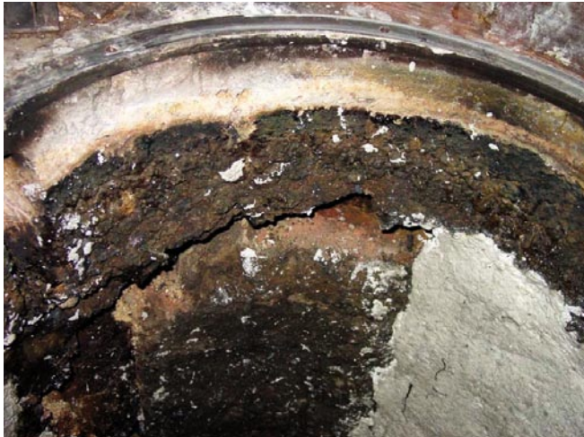
Schäden durch schadhafte Kesselausmauerung
