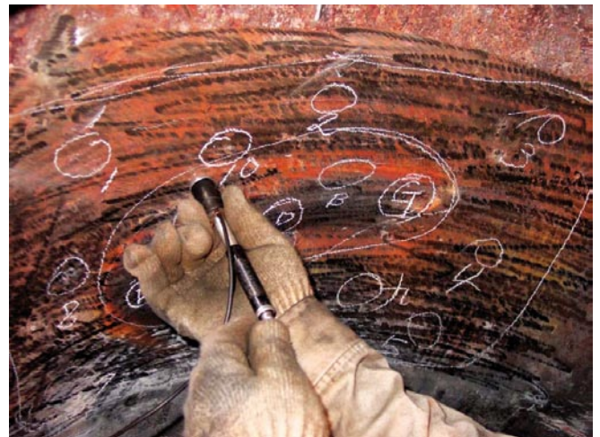
Härteprüfung zur Abschätzung des Schadensumfangs (Besichtigung des Schadens)
